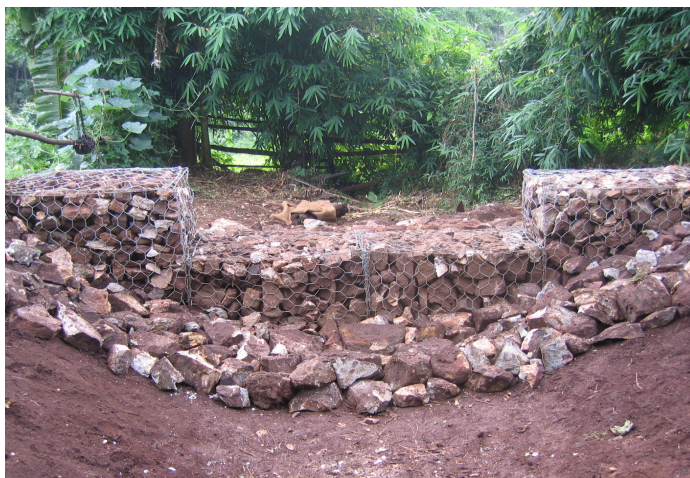
ภาพที่ 7.1 อาคารชะลอแบบเกเบี่ยน
